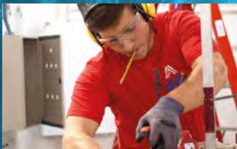
// Electrical Installations / Elektrotechnik
